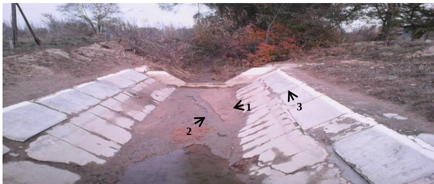
Рис. 2. Водомерное сооружение с трапецеидальным водосливом ЗБК.
